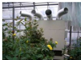
燃油の使用低減 （施設園芸用ヒートポンプの活用）
